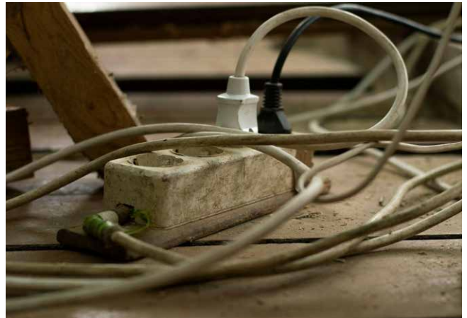
Sicherheitsmngel auf Baustellen (Foto: Shutterstock)
