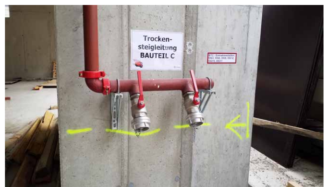
Sicherstellung der Löschwasserversorgung Trockensteigleitungen (Foto: ADSUM)
