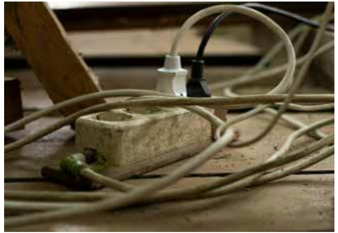
Sicherheitsmängel auf Baustellen (Foto: Shutterstock)
