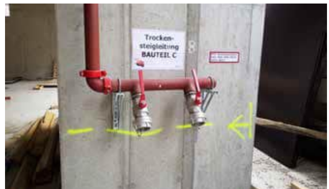
Sicherstellung der Löschwasserversorgung Trockensteigleitungen (Foto: ADSUM)
